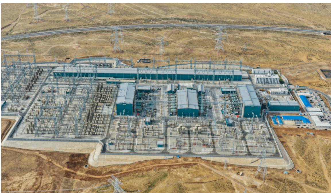
宁夏 - 湖南 \pm 800 千伏特高压直流输电工程
