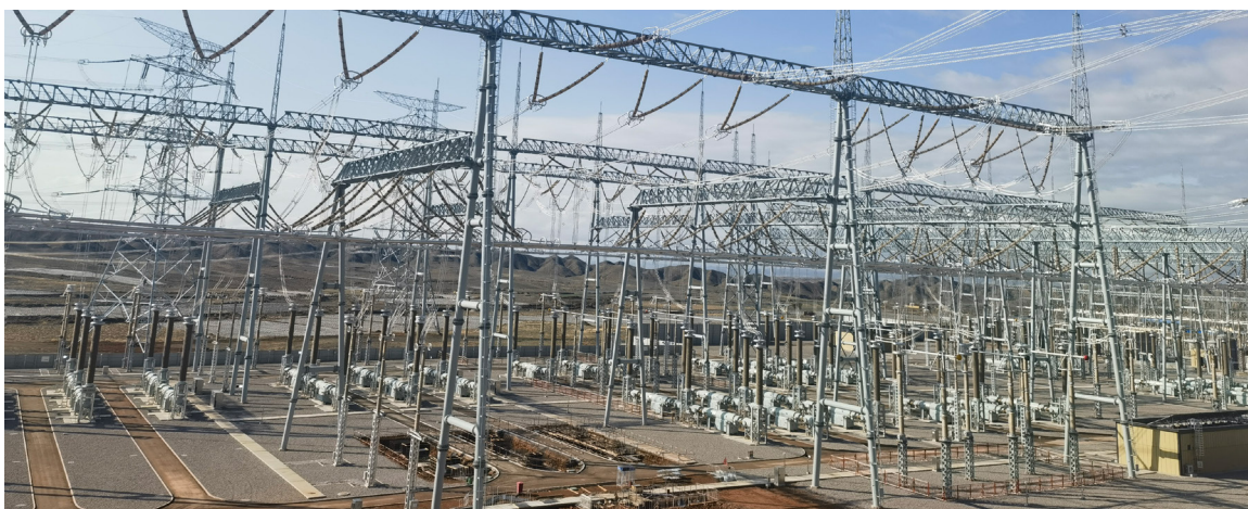
宁夏天都山 750 千伏输变电工程
